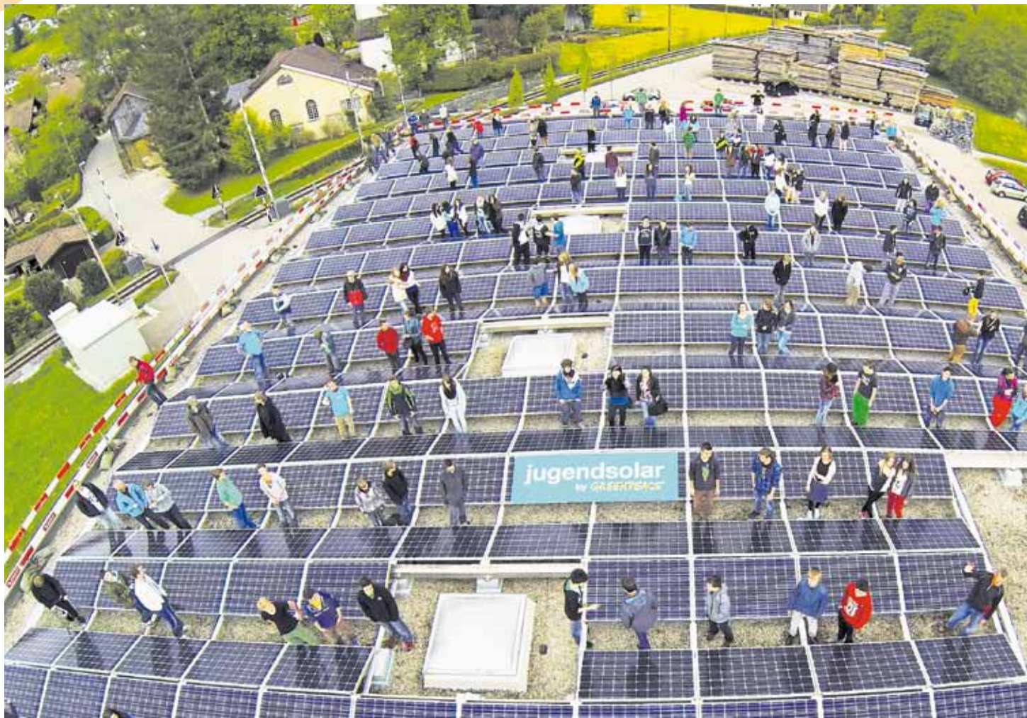
140 Schüler bauten auf dem Dach der Firma Alder & Eisenhut gemeinsam eine Solaranlage.
