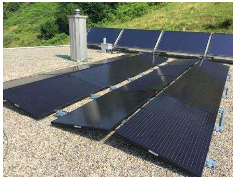
EFH Ebnat-Kappel 5 kWp auf Flachdach
